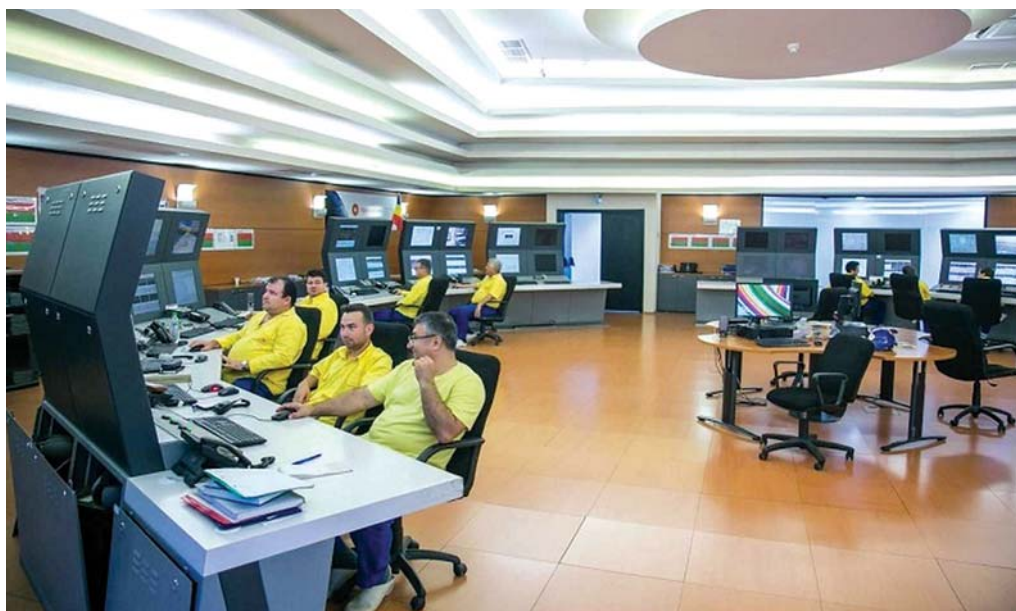
Комната управления на НПЗ Petromidia в Румынии, фото из архива пресс-службы КМГ
