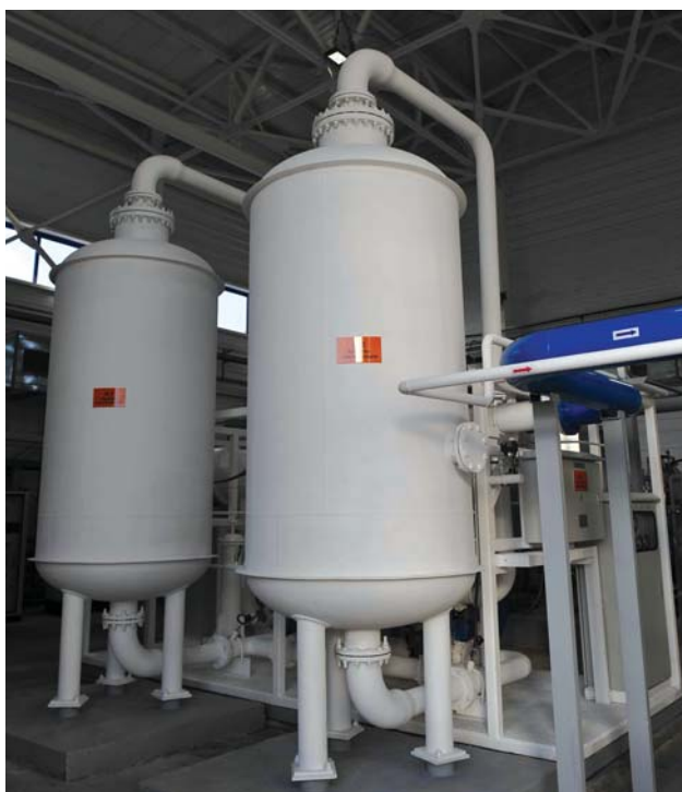
Адсорберы очистки воздуха А-1 и А-2
