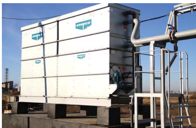
Градирня для охлаждения воды в закрытых системах
