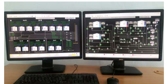
Станция оператора новой PCU Delta V ТСП ККОН
