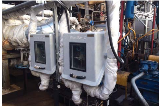
Новые обогреваемые шкафы «РИЗУР» с приборами на КППН и КГПН
