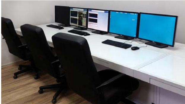
Новая инженерная комната PCU ЛК-6у КППН
