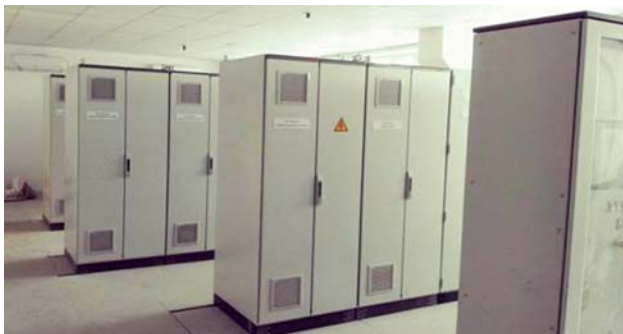
Новая аппаратная PCU Yokogawa Centum VP на КТ-1 комплекса глубокой переработки нефти
