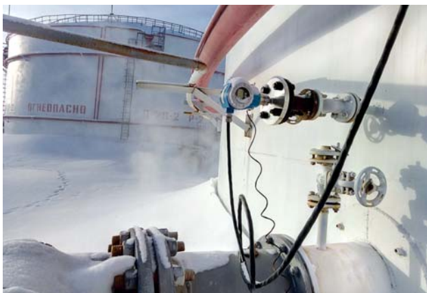
Датчик давления новой системы учета Tank Gauging от Endress+Hauser на резервуарах топливно-сырьевых парков ККОН
