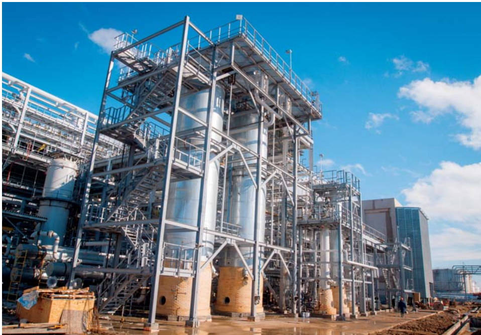
Установка изомеризации и сплиттера нефти – два реактора установки Репех А100-Р002 А/В
