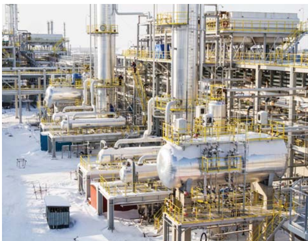
Комбинированная установка производства серы
