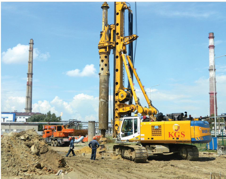
Компания «KGS – Astana» на устройстве свай под фундаменты колонного оборудования установки изомеризации
