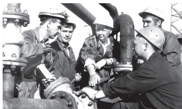
Сентябрь, 1997 год. Слева направо: В. Бресский, Д. Бресский, В. Комкин, Н. Щетинин, Н. Комкин обсуждают план демонтажа насоса на резервуаре П-29-1
