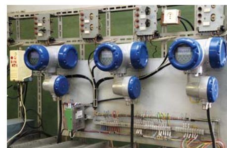
Конвертер MFC 300 массовых расходомеров OPTIMASS. Установлен на КТ-1.
