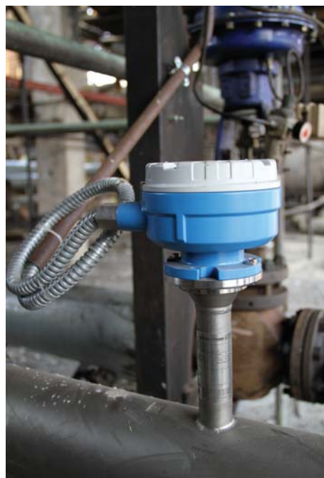
Сенсор массового расходомера PROMASS. Установлен на КТ-1.
