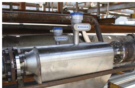
На переднем плане высокотемпературный массовый расходомер OPTIMASS 8300. На заднем – OPTIMASS 2300. Установлены на ЛК-6У.
