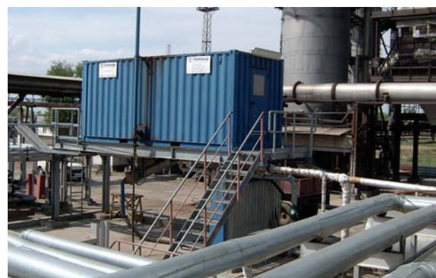
2003 год. Установка по переработке нефтешламов «Flottweg»
