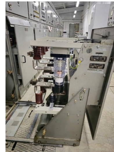
РУ-6кВ РП-080 Согласно инвестиционной программе ТОО "ПНХЗ" на услуги по передаче и распределению электрической энергии, выполнены работы по замене высоковольтного вакуумного выключателя ячейки № 3
