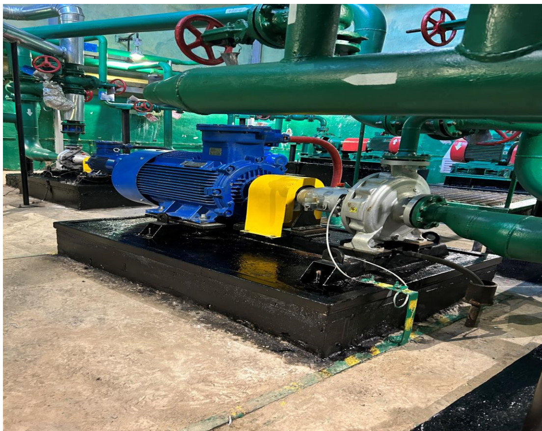
Фото насоса СНР (АА)-50-315 инв.№000276592
