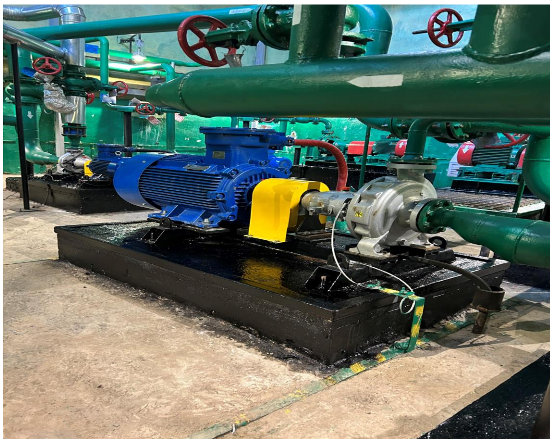
Насос СНР (АА)-50-315 инв.№000276592 фотосы
