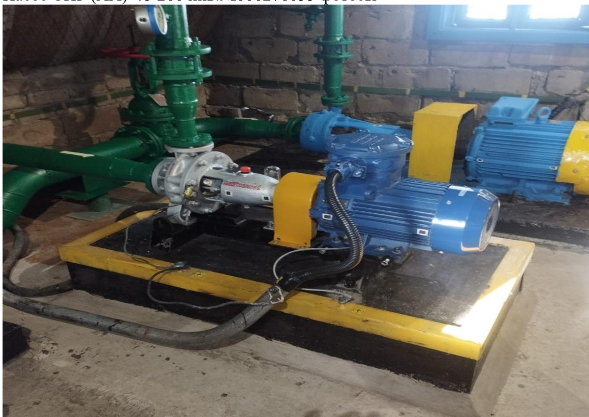
Насос СНР (АА)-40-200 инв.№000276055 фотосы
