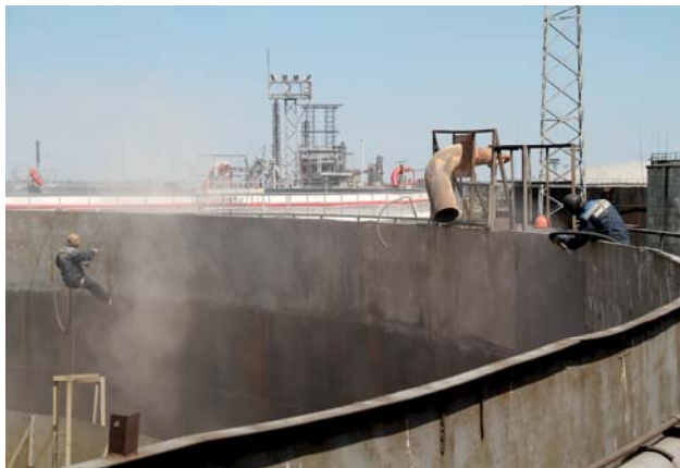
Пескоструйные работы внутренней поверхности верхнего пояса Р-1 парка 29-1 на участке ТСП, цех №2. Работы ведут специалисты ТОО «Казтеплоспецстрой» (г. Усть-Каменогорск)
