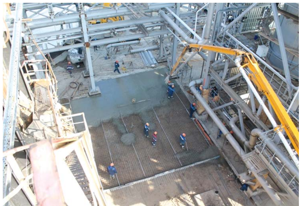
КППН, секция 300 (гидроочистка дизельного топлива). Заливка площадки для новых реакторов гидроочистки дизтоплива Р-301/1,2. Исполнитель работ – ТОО «МегаСтройПлюс», субподрядчик – ТОО «ПавлодарСпецМонтаж»
