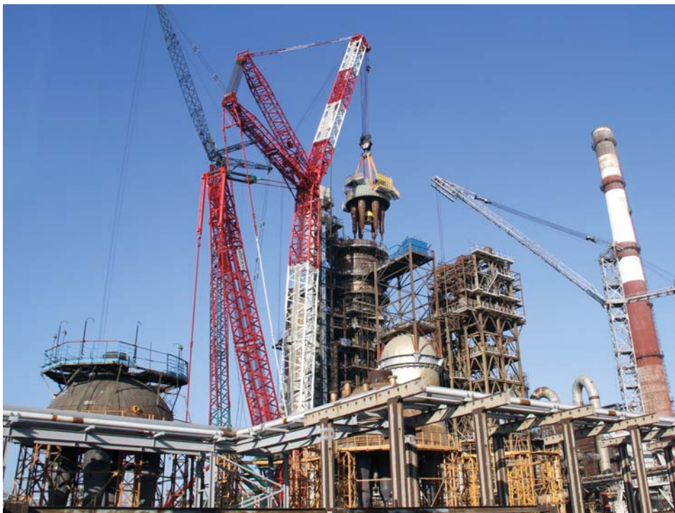
КГПН, С-200. Монтаж верхнего днища (купола) реактора Р-201 со сборными камерами и группами циклонов. Исполнитель работ – ОАО «ОМУС-1»
