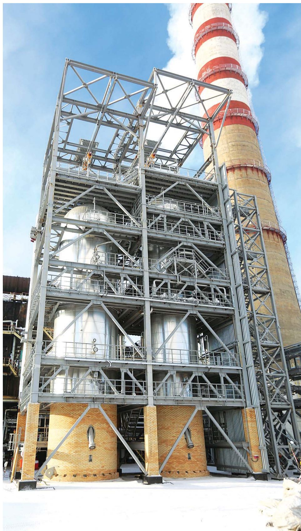
Установка гидроочистки дизельного топлива комплекса первичной переработки нефти (КППН) после реконструкции. Реакторы Р-301/1,2
