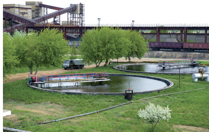
Радиальные отстойники на биологических очистных сооружениях
