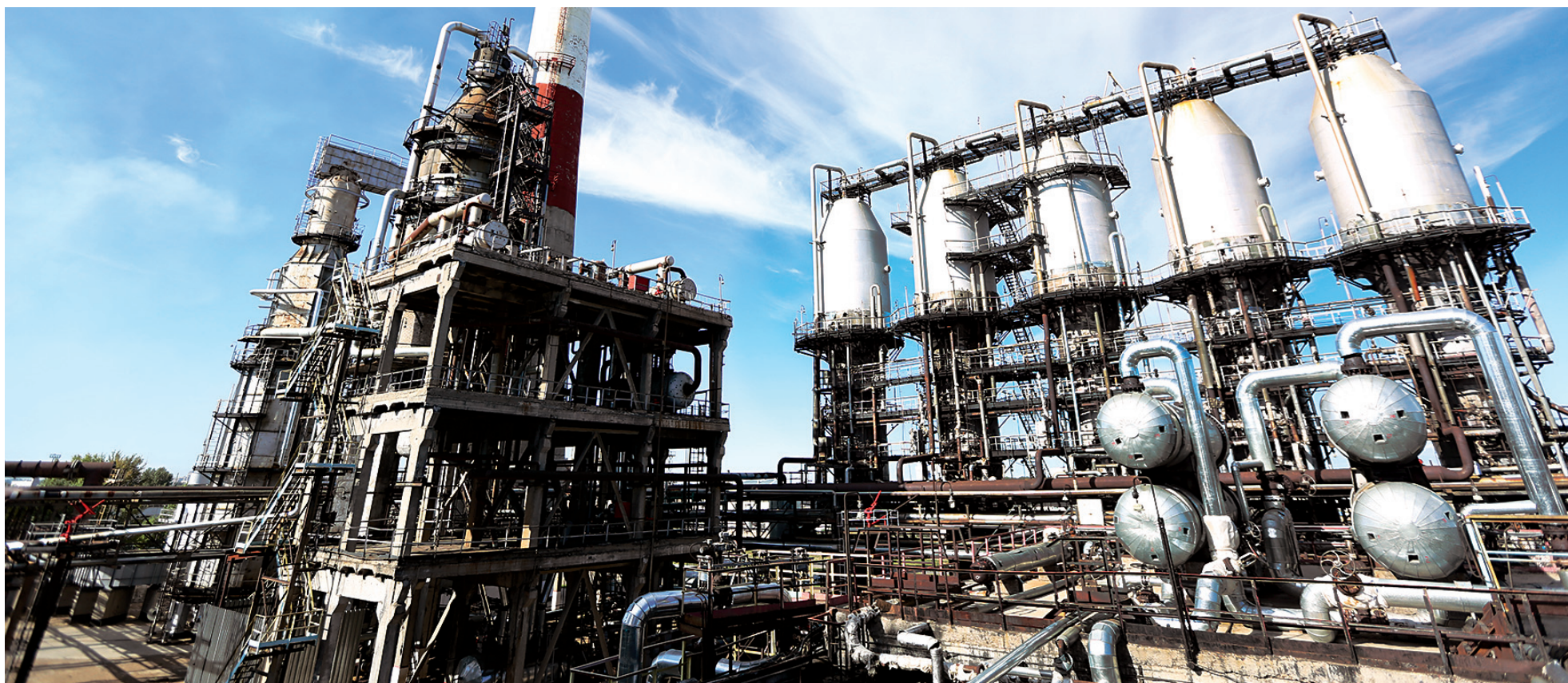
Установка производства битумов
